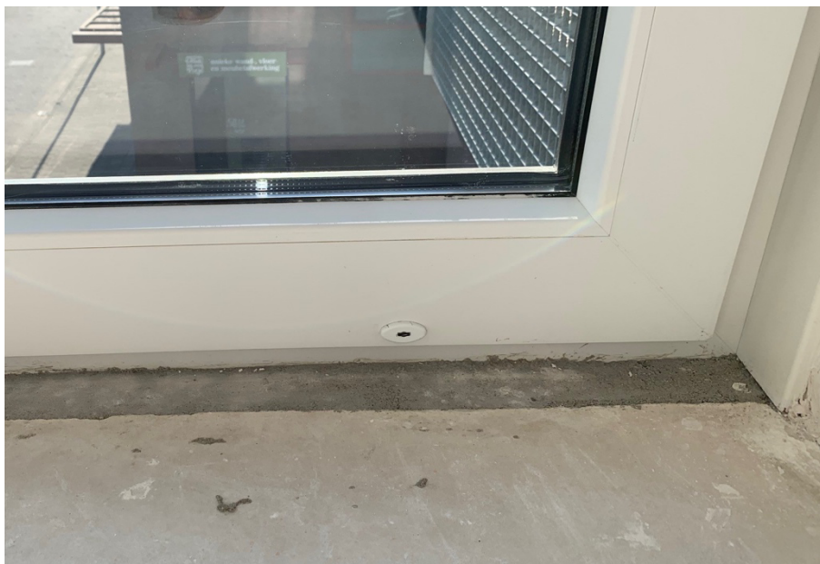
Figuur 1 verdiepinghoog draaiend deel met zichtbaar slotgat waarmee de draaifunctie is vastgezet.
